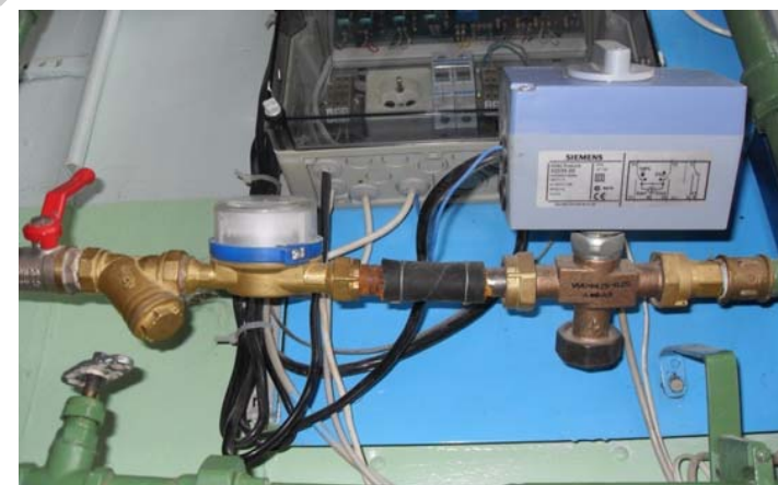
Рис. 4.40. Блок контроля подачи воды на увлажняющую машину
